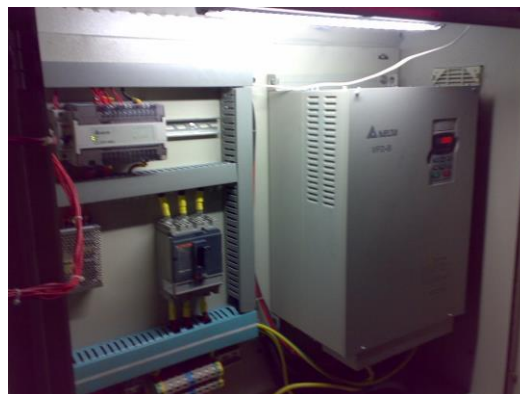
شکل ۷-۵: نمای تابلوی سیستم تنظیم دور پمپ جهت تامین هد ثابت
